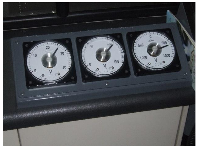
24V 電圧・100V 電圧・架線電圧
